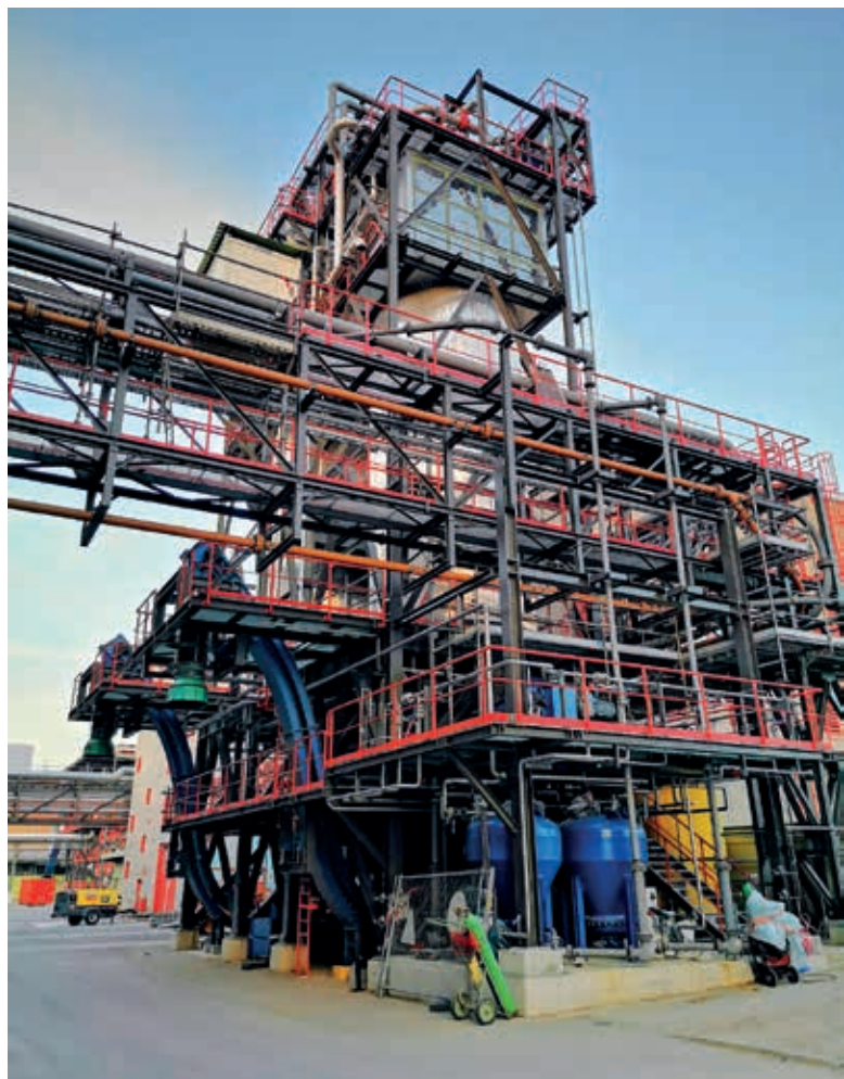
Postrojenje za sušenje otpadnog mulja Simmeringer Haide (Foto: Wien Energie)
